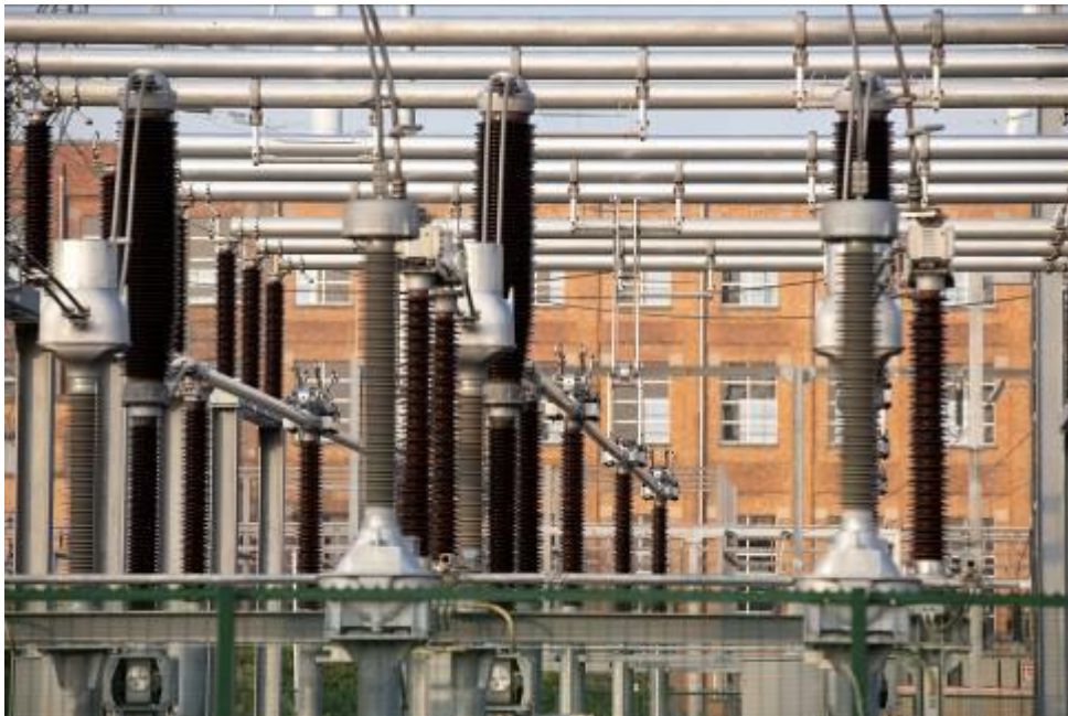
Afbeelding 3.8 Zicht op het transformatiestation van Elia en de generatorhal
