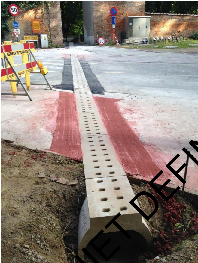
Figuur 13.16. Voorbeeld van een amfibieëntunnel (bron: wegen en natuur).
