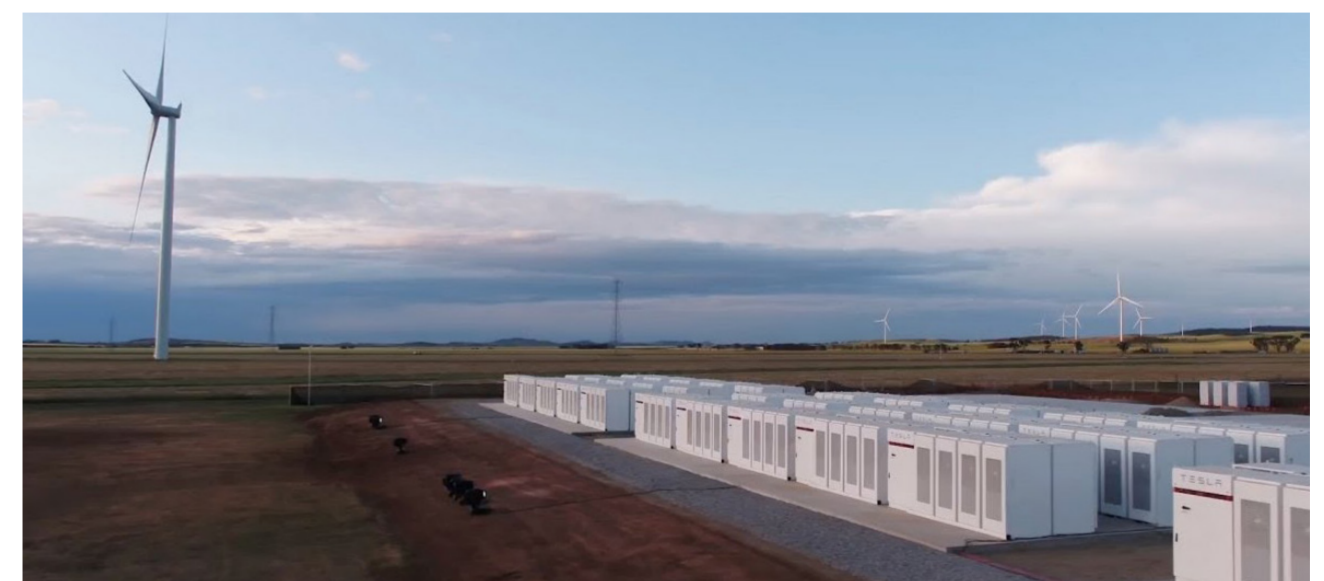
batterij-opslag en windmolens Tesla Australië
