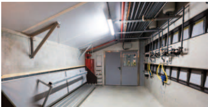
Conditioneringsruimte met regelbare luchtinlaatklep en 'twin'-verwarmingsbuizen
