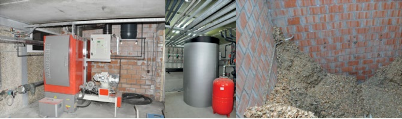
Afbeelding 13. Van links naar rechts: biomassa-installatie 80 kW, buffervat met een volume van 2000 l, voorraadbunker van ±30 m 3
