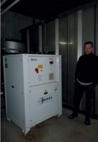
Afbeelding 16. Warmtepomp met buffervat
